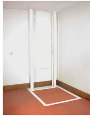
Premier étage lorsque l'élévateur est au rez-de-chaussée
